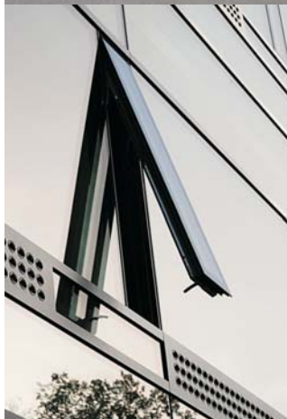
Öffnungsflügel zur natürlichen Lüftung
